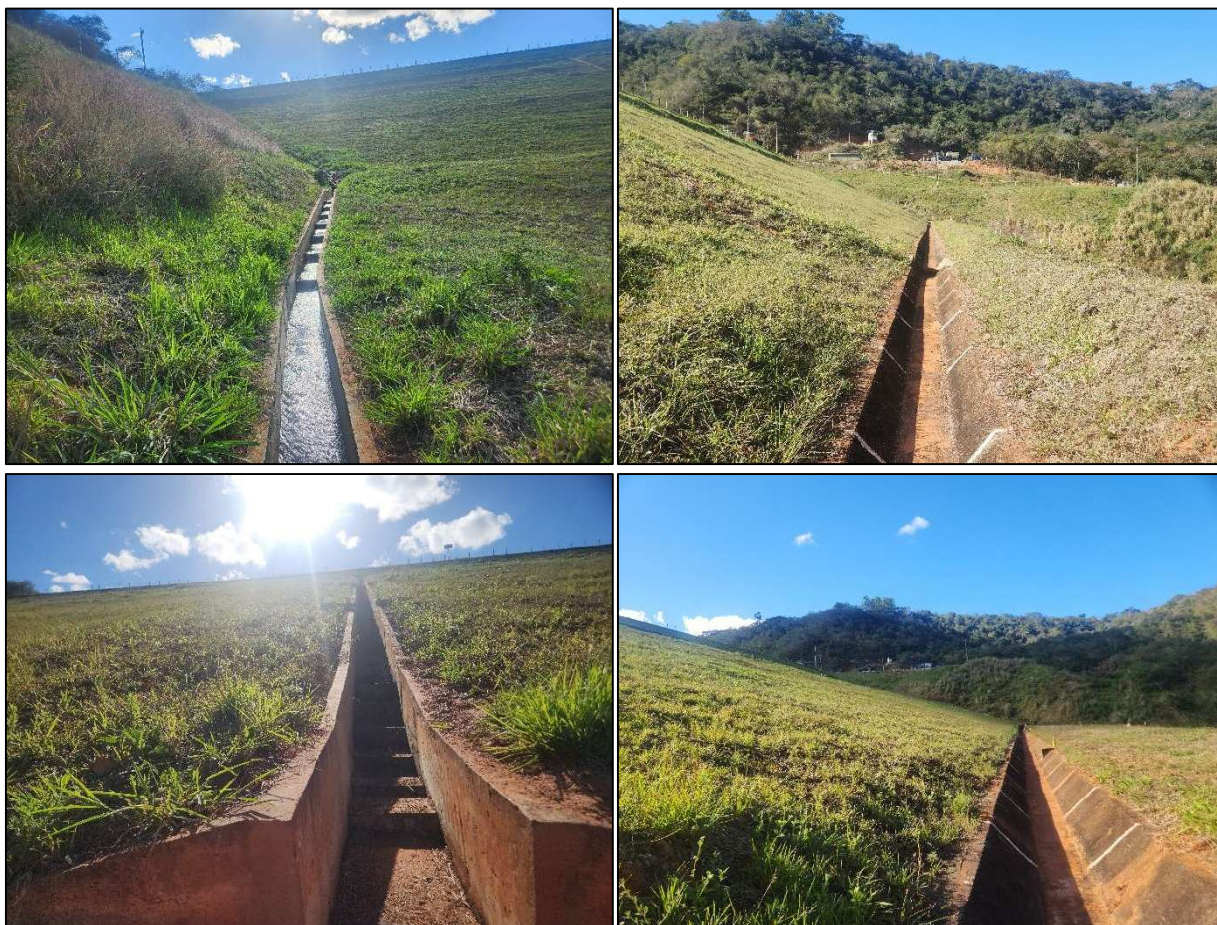
Figura 6.5 – Dispositivos de drenagem superficial presentes na Rancho Casca
