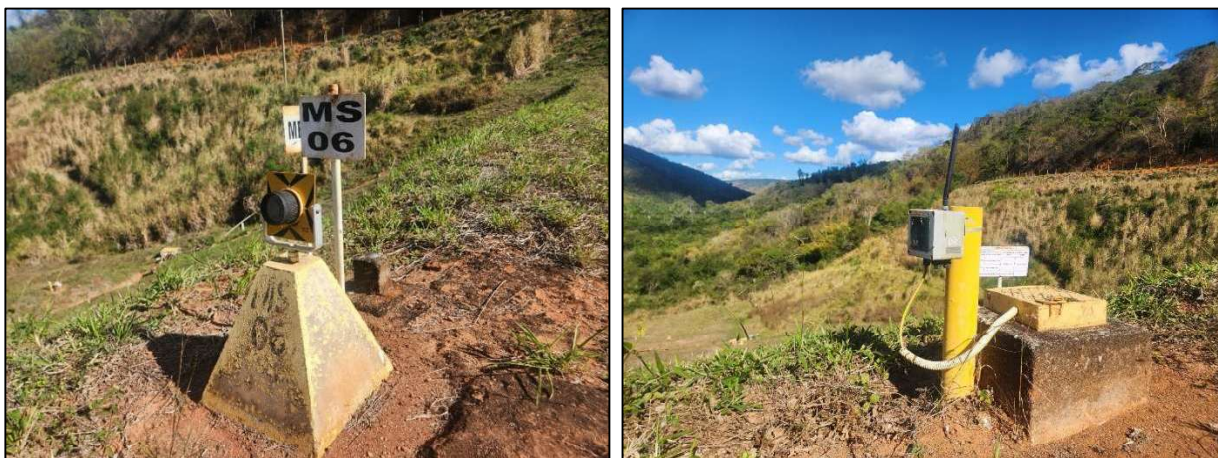
Figura 22.6 – Instrumentação da Barragem Rancho Casca
