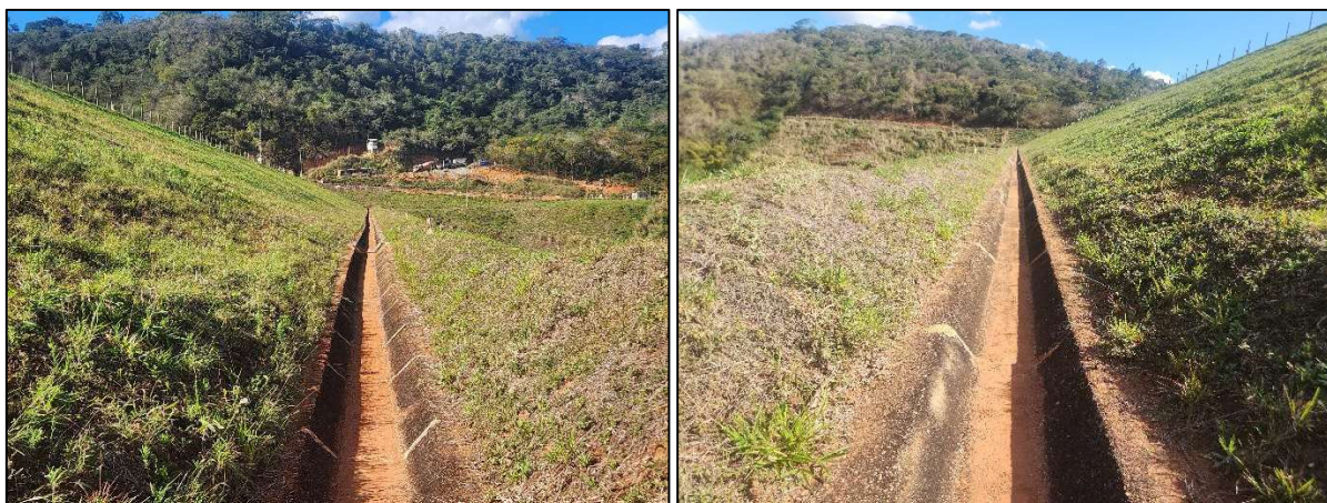
Figura 22.9 – Dispositivos de drenagem superficial presentes na Rancho Casca
