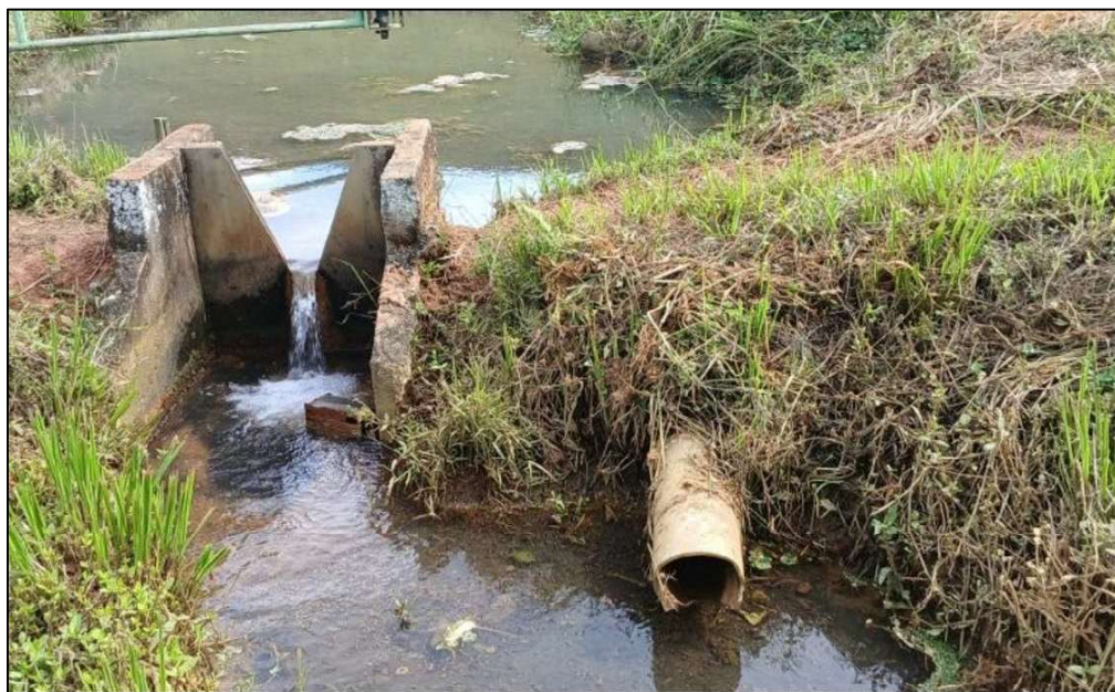
Figura 22.8 – Medidor de vazão da saída da drenagem interna Barragem Rancho Casca
