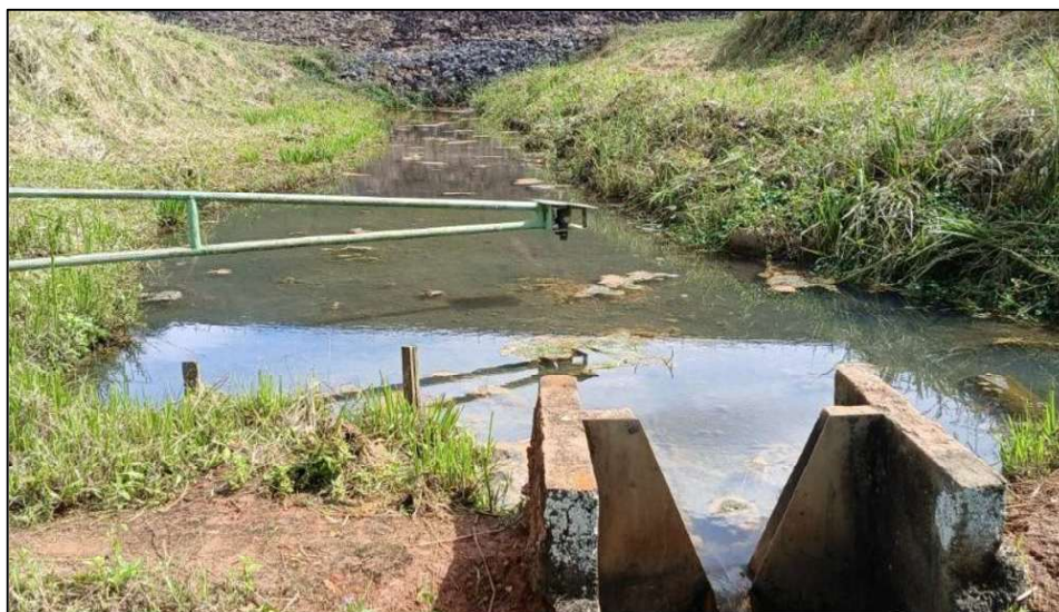
Figura 22.7 – Saída do dreno de fundo da Barragem Rancho Casca
