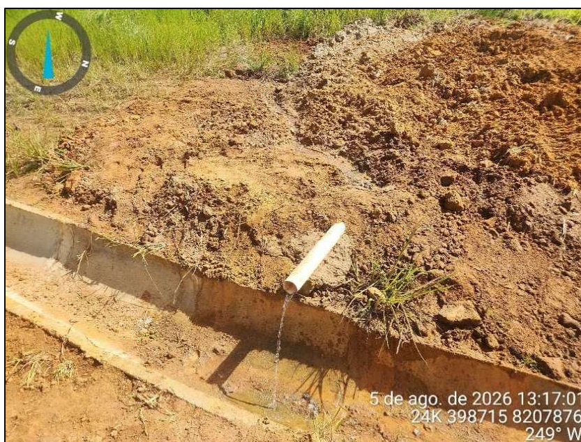
Figura 7.3 Surgência da ombreira esquerda no extravasor
