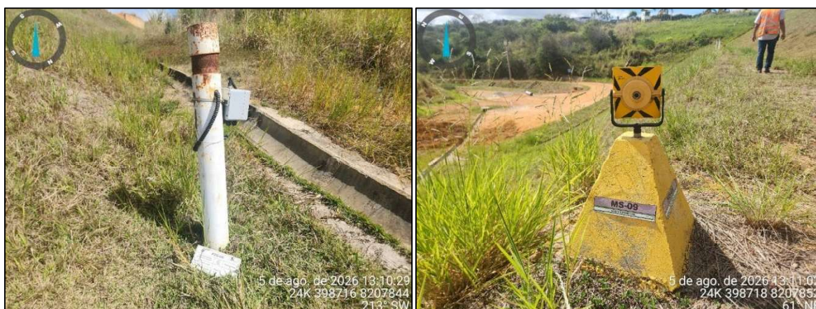
Figura 22.8 – Instrumentação da Barragem Califórnia registrada durante visita técnica
