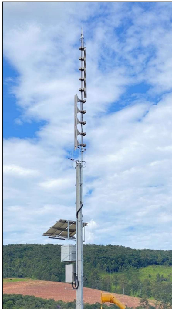
Figura 13.1 – Sirene implantada próxima a ZAS da mancha de inundação da estrutura de contenção de rejeitos B2
